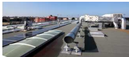
Exemple d'installation bruyante
